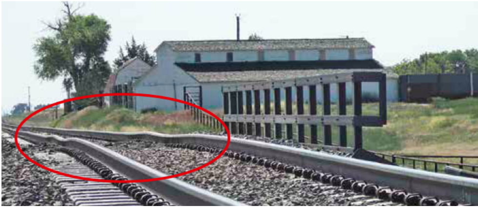
Figure 2.7: Dégradation de voie par tassement du ballast [39]
