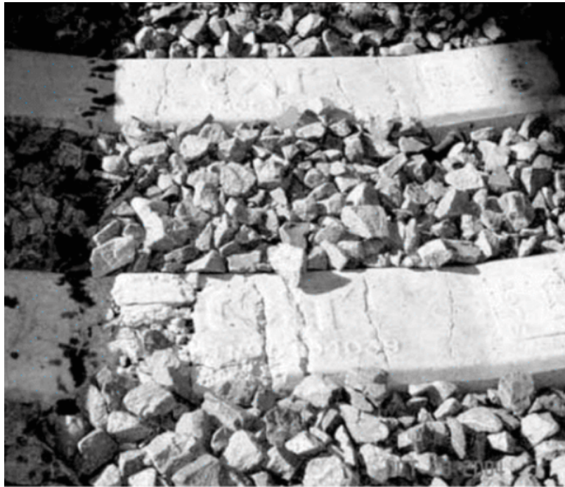
Figure 2.9: Traverse en béton fissurée en approche d'un pont ballasté [18]
