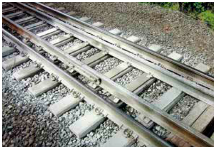
Figure 2.8: Taches blanches, signes d'usure des matériaux [39]
