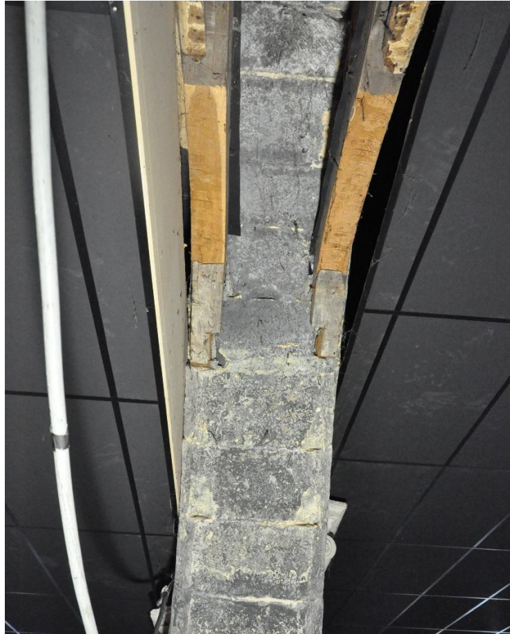
Figure 46. Huy, Église Saint-Mengold , intrados de l'arc de la première travée du collatéral nord : vue depuis la tribune en béton (©Gabriel Bister, 2025).
