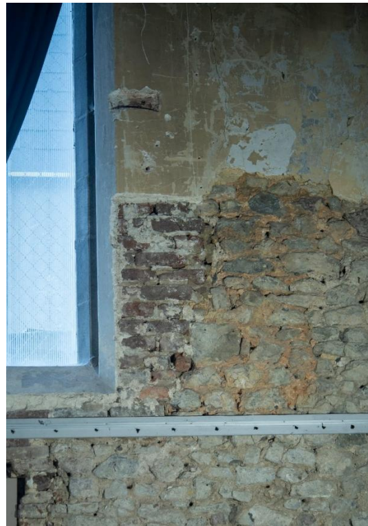
Figure 73. Huy, Église Saint-Mengold , extrémité orientale du mur septentrional du collatéral nord, détail des campagnes de ragréages des baies : vue depuis la nef (© Alexandre Bister, 2025)
