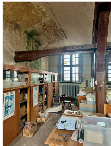
Figure 54 : Infiltrations sur le pignon nord. © Anna Denis (2025)
