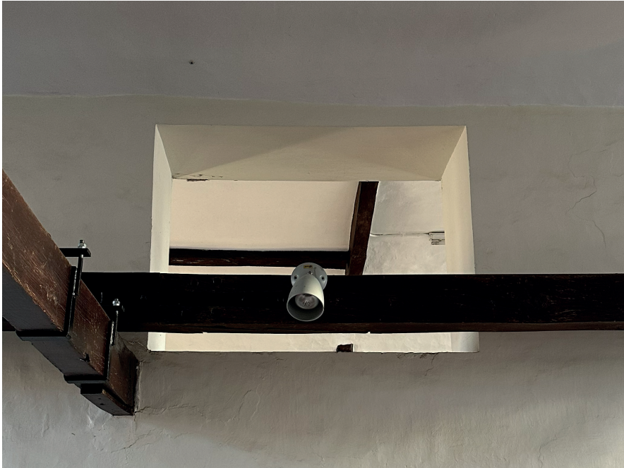
Des ouvertures en haut des murs de séparation assurent la ventilation naturelle et la diffusion de la chaleur.
