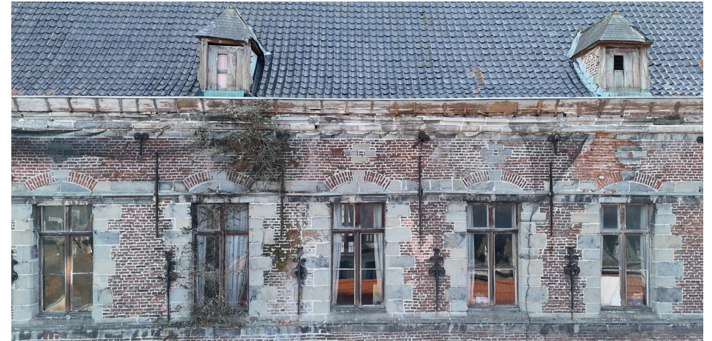
Figure 52 : Multiples pathologies sur la façade. © Valentin Bouvry (2026)
