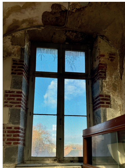
Figure 55 : Dégradation de la voute suite aux infiltrations. © Anna Denis (2025)
