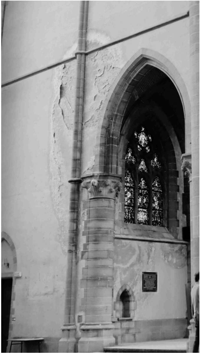
intersection entre le transept et la chapelle humidité dans les murs
