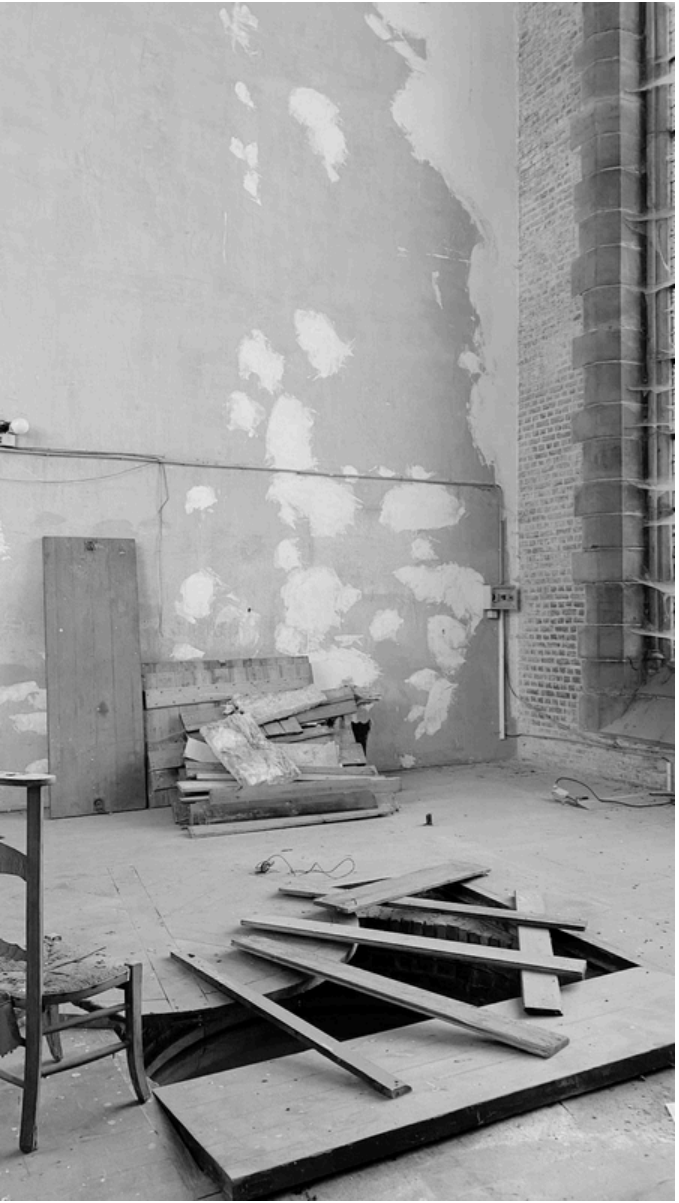
dans le jubée dégradation du crépis
