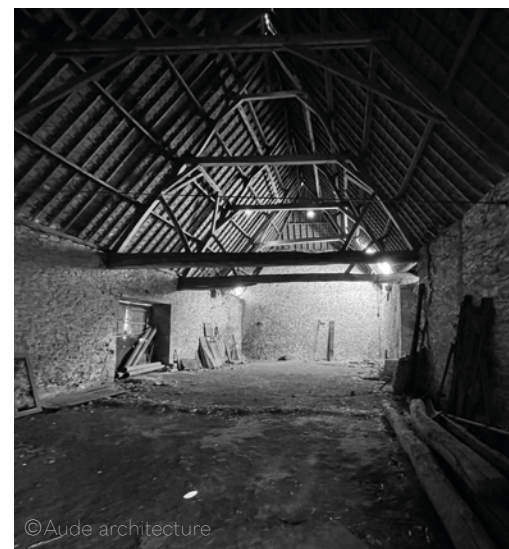
◀ Fig.99 Charpente écurie Fig.100 Toiture détruite boxs ▶ ▶ Fig.101 Charpente grange Fig.102 Grange et douve ▶
