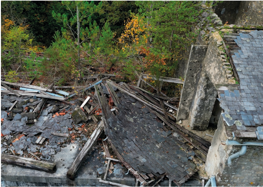
Photo de la toiture effondrée. La végétation a repris le dessus sur la ruine, même au dernier étage.
