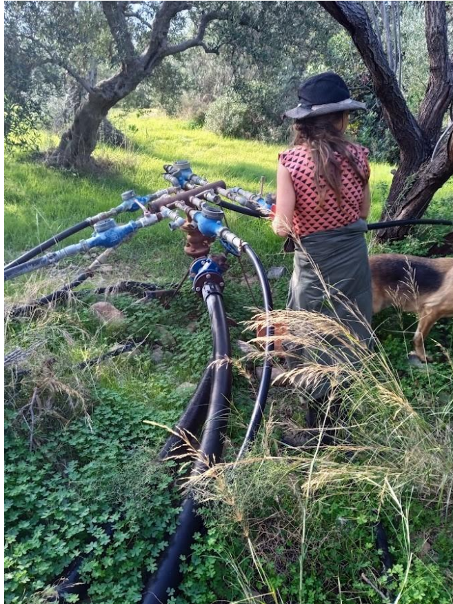
Ouverture des vannes d'eau potable, octobre 2022.
