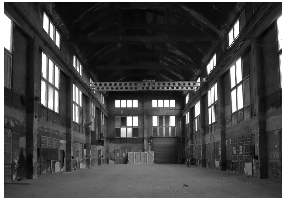
Figure 72 : Photographie intérieure de la halle Est de la salle des machines.
