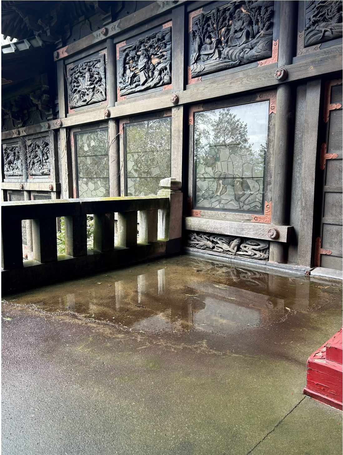
Figure 78 dalle du perron de la Tour, présentant une importante stagnation d'eau en l'absence d'évacuation, 16 avril 2024 ©Büsra Jouant
