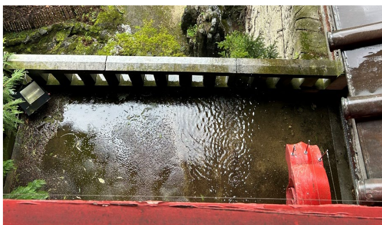
Figure 77 photographie de la dalle du perron de la Tour japonaise sous la pluie, illustrant l'absence d'évacuation des eaux, 16 avril 2024 ©Büsra Jouant
