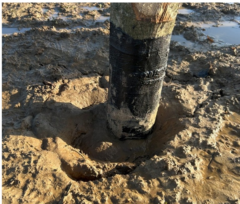
FIGURE IV.15 – Tassement du sol autour d'un poteau.
