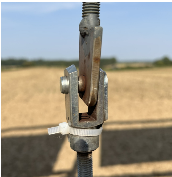
(a) Corrosion sur la rotule mécanique.
