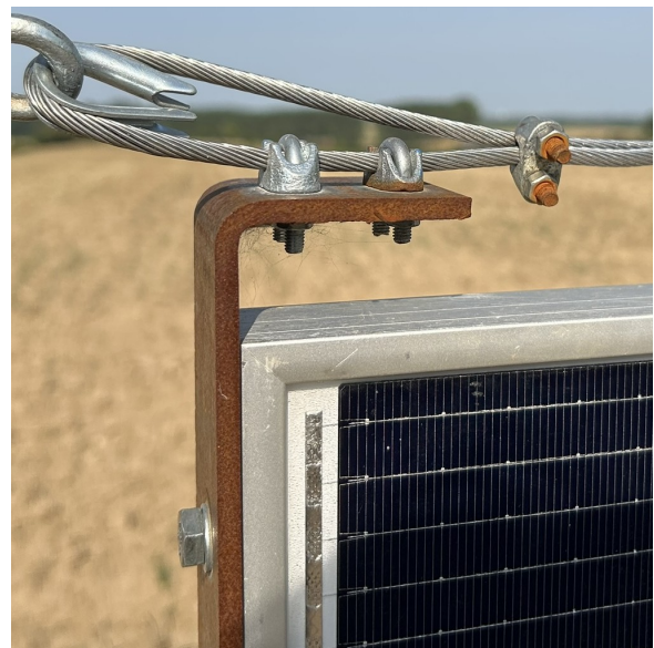
(b) Corrosion sur le système à câbles.
