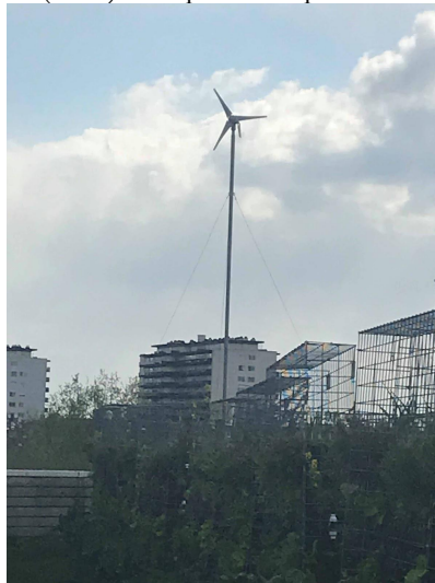
Mini éolienne sur la toiture du projet “Peas and love”
