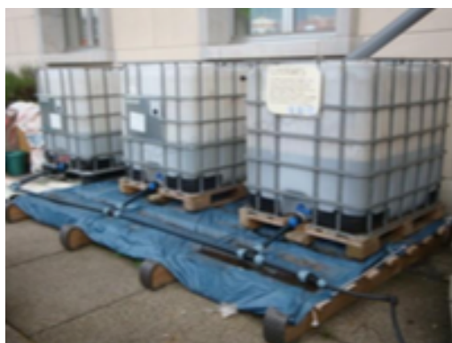
Citernes de récupération d'eau de pluie sur les toitures de la bibliothèque royale
