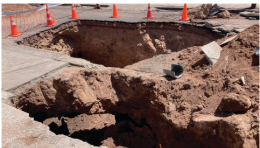
Fig. 63 : Photographie sol effondrable © El desconcierto
