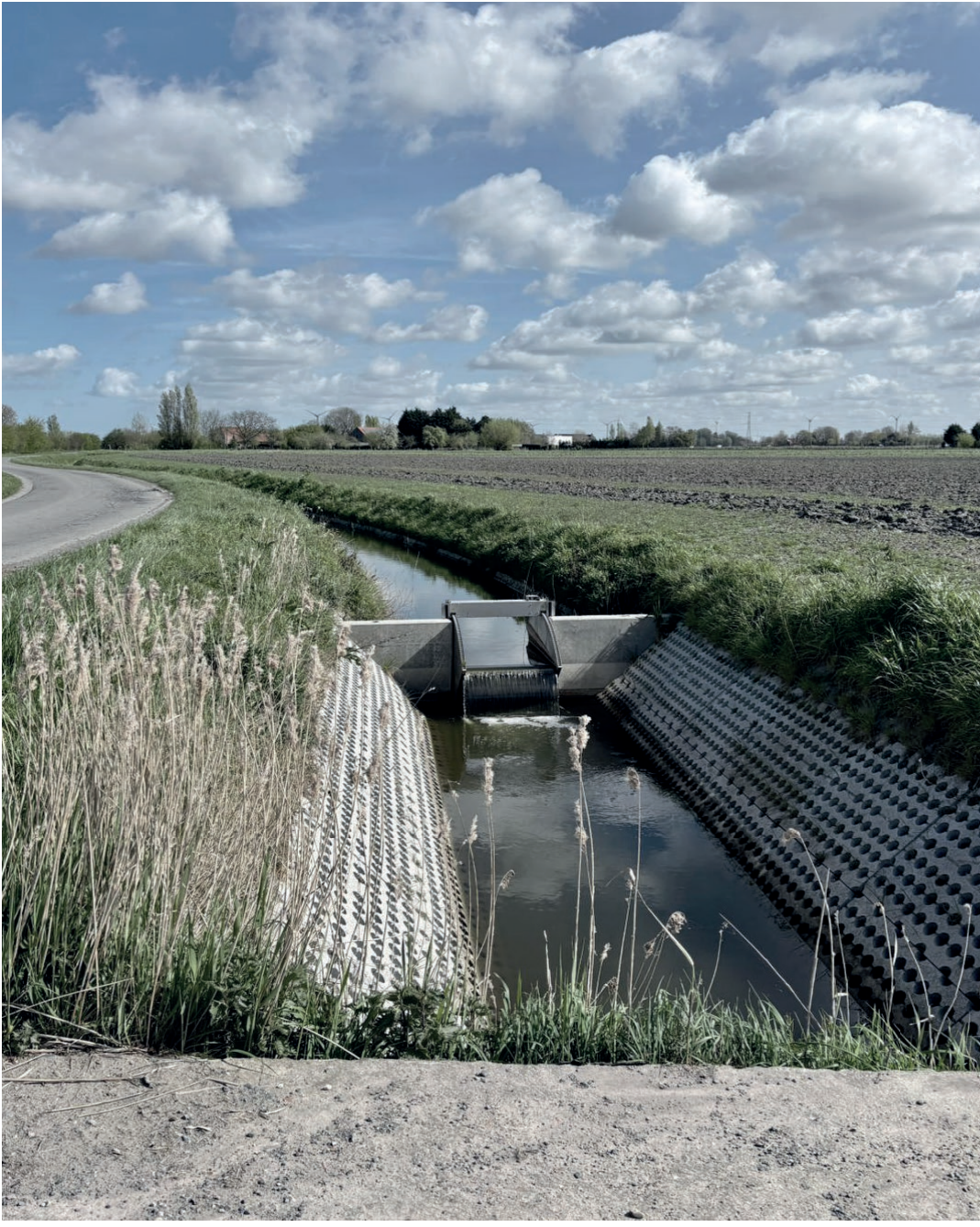
Un barrage à poutrelles amovibles, proche de Meetkerke
