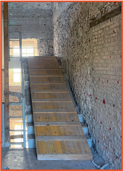
Traces de l'ancienne circulation centrale obturée qui conduisait aux différentes salles de classes aux étages
