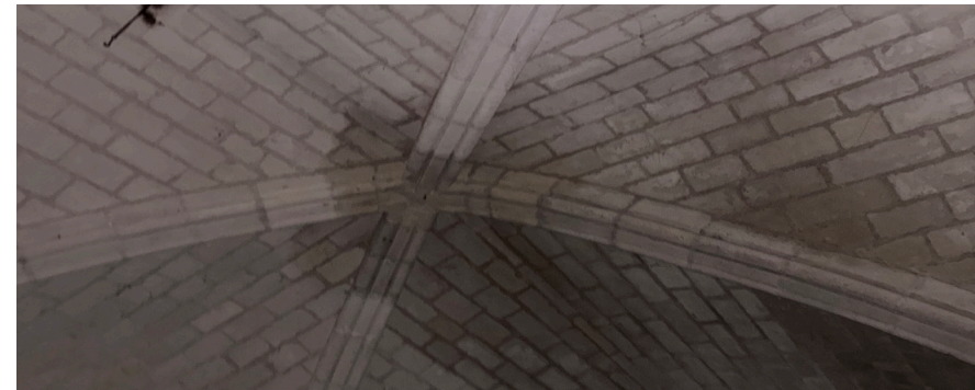
Fig 106 : Photo des voutes des celliers
