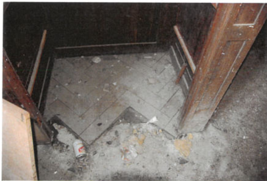
Parquet salle de réception
