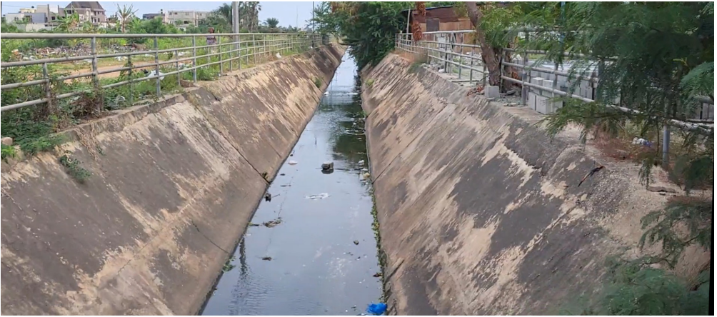
Fig. 31 : Un collecteur (lui-même pollué) qui relie un bassin de retention à la lagune
