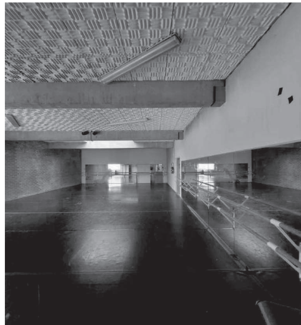
Fig. 77 : salle Bernard Jeu, miroirs cassés et fissures dans les murs
