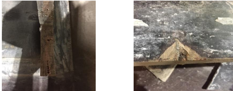
Figures 165 - Dégradation des plaques de coffrage
