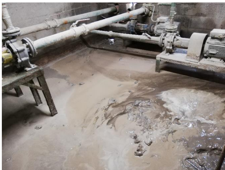
Photos du 12/02/2020 (local des pompes, TIMAC, 2020)
