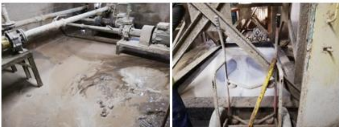
17/02 ; 09/03 : eau toujours présente ; écoulement des eaux provenant du local de stockage à l'air libre. Nouvelle fuite et même scénario
