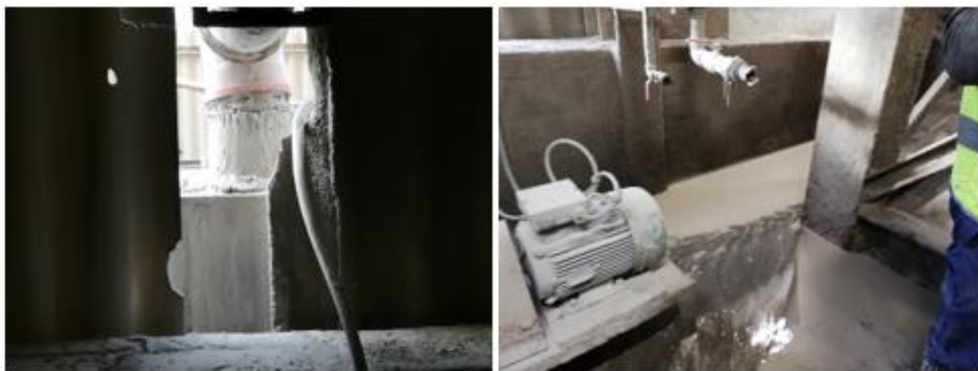
c. Tuyauterie qui coule, vieille, demande entretien ou remplacement
