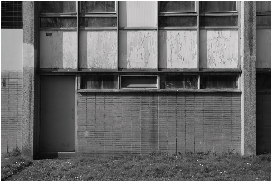
Fig. 11 - Dégradation des RDC bloc 6, Cité Modèle
