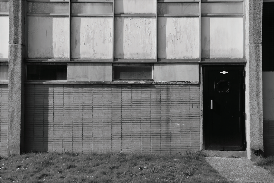
Fig. 10 - Dégradation des matériaux bloc 6, Cité Modèlee
