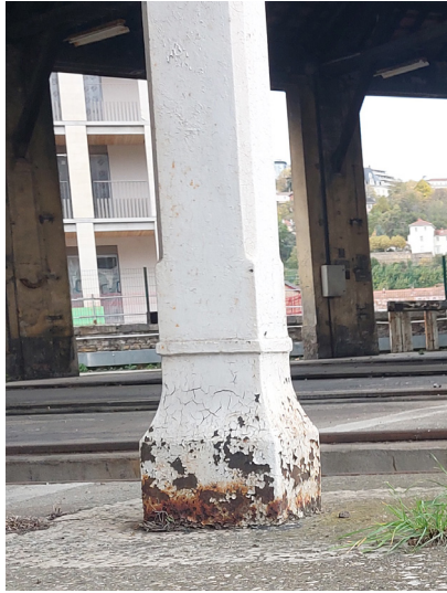
Fig. 102 : Peinture du poteaux qui s'effrite et rouille
