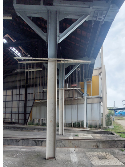
Fig. 103 : Poteaux de la structure qui ont été déplacé
