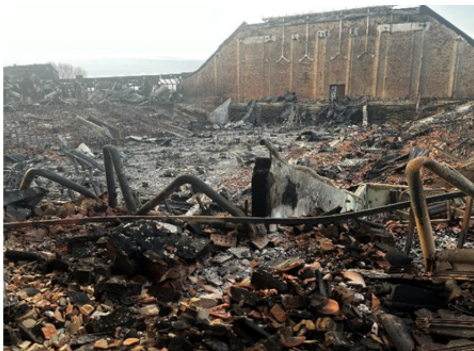
Figure 61 : Photo de la salle du BCM gravelines après l'incendie
