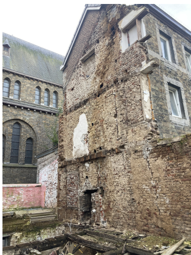
FIGURE 3.10 – Ruines d'un bâtiment. [RYCKMANS 2022]
