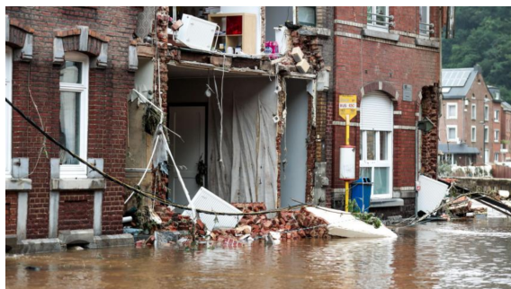
FIGURE 2.2 – Inondation fluviale de Pepinster en juillet 2021 [LE SOIR 2021].
