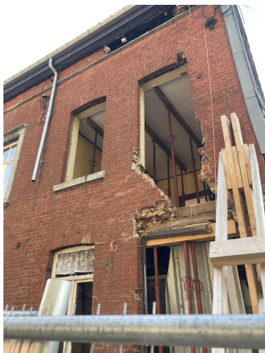
FIGURE 3.8 – Bâtiment partiellement détruit. [RYCKMANS 2022]
