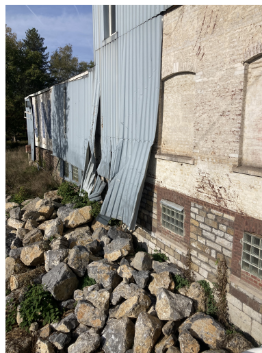
FIGURE 3.9 – Déformation de la taule sur un bâtiment. [RYCKMANS 2022]
