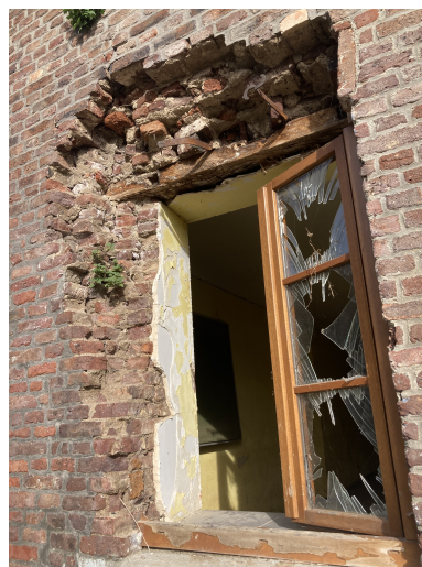
FIGURE 3.11 – Vitre et cadre de fenêtre lourdement endommagés. [RYCKMANS 2022]
