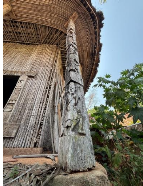
Figure 78: dégradations des bois
