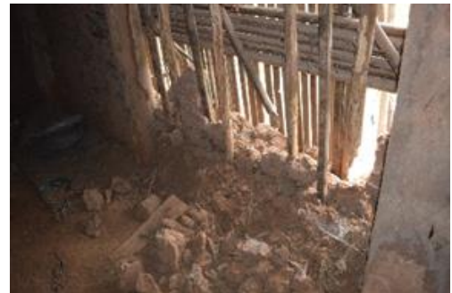
Figure 80 : Effritement de la terre
