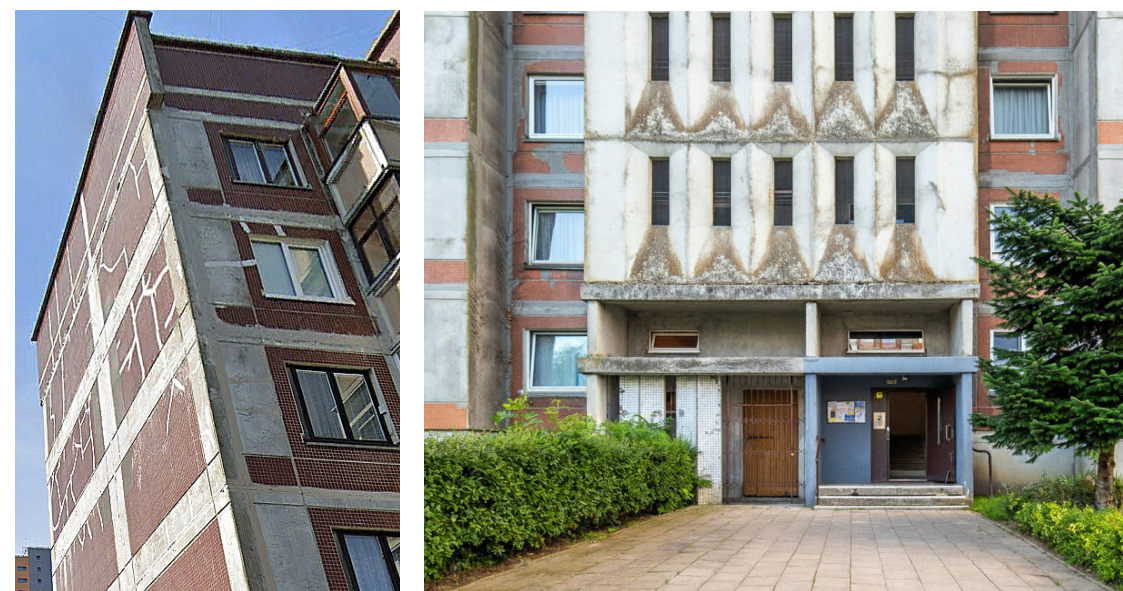
Fig 58. La dégradation des façades aperçues sur les immeubles du quartier «Varpai», 2026.
